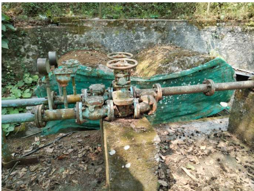
Imagen 2. Infraestructura abandonada de la red de agua potable de Acuatla. Acervo personal del autor
