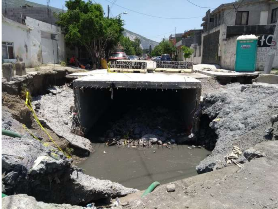
Figura 1. Socavón en Colonia Santa Lucía La Granja, Monterrey. Al fondo barricadas de concreto con denuncias vecinales expresan: «Exigimos avance, qué esperan, tienen $$$» y «50 millones guardados, obra olvidada / Obras pub. incapaz». Archivo fotográfico de campo, 2018. Archivo de la autora.
